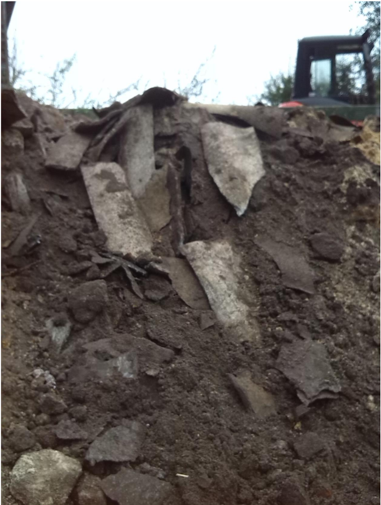
Foto 7: grote stukken asbesthoudend golfplaat t.p.v. inspectiesleuf S1
