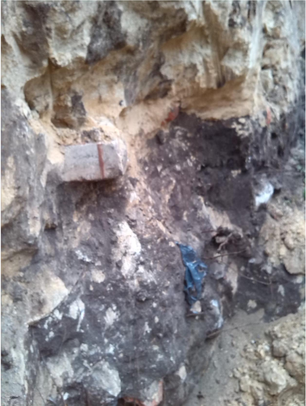
Foto 8: begraven puin t.p.v. inspectiesleuf S1
