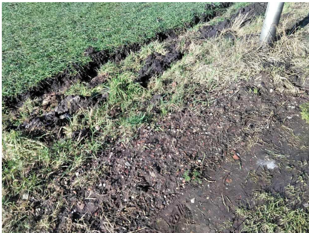
Foto 1. Puin in berm Margienewijk, Nieuw-Amsterdam
