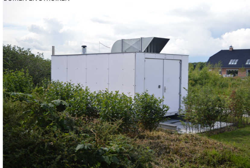
DE ACHTERZIJD VAN HET HOTEL BIED PLAATS AAN DE VERSCHILLENDE NUTS VOORZIENINGEN. DIT ZIJN LELIJKE ELEMENTEN EN DUS HET LIEFST UIT HET ZICHT VERTROKKEN
