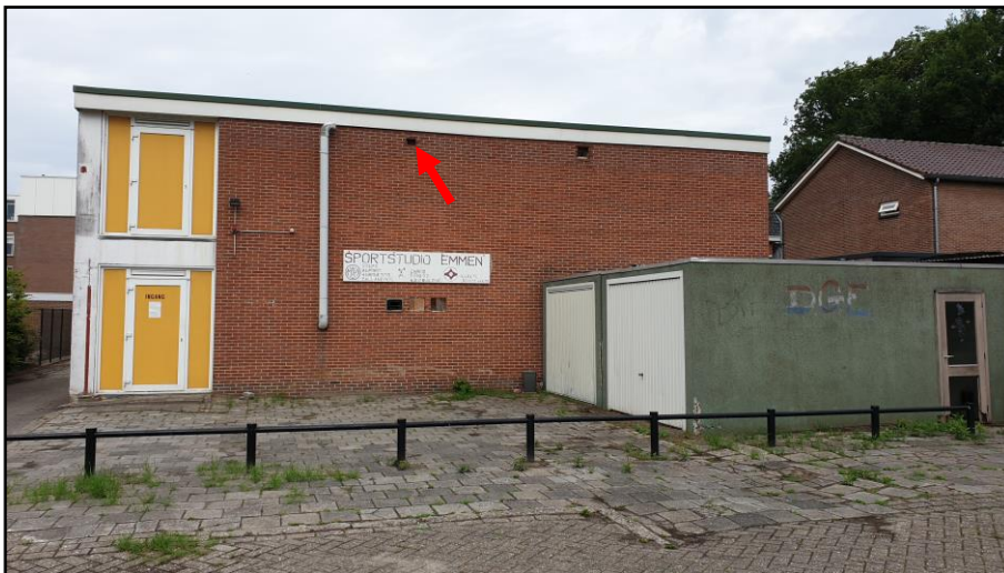
Figuur 4.2 Kauwen hebben een nest gebouwd in een gat van de oostelijke muur (locatie met een rode pijl aangegeven).
