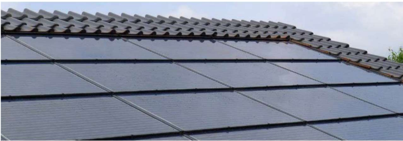
Zonnepanelen: regelmatig patroon in overeenstemming met dakvorm
