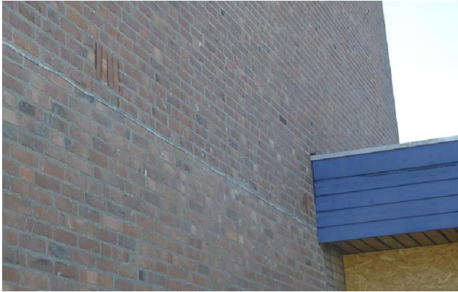
Foto 5 Open stootvoegen in de naastgelegen portieketageflat
