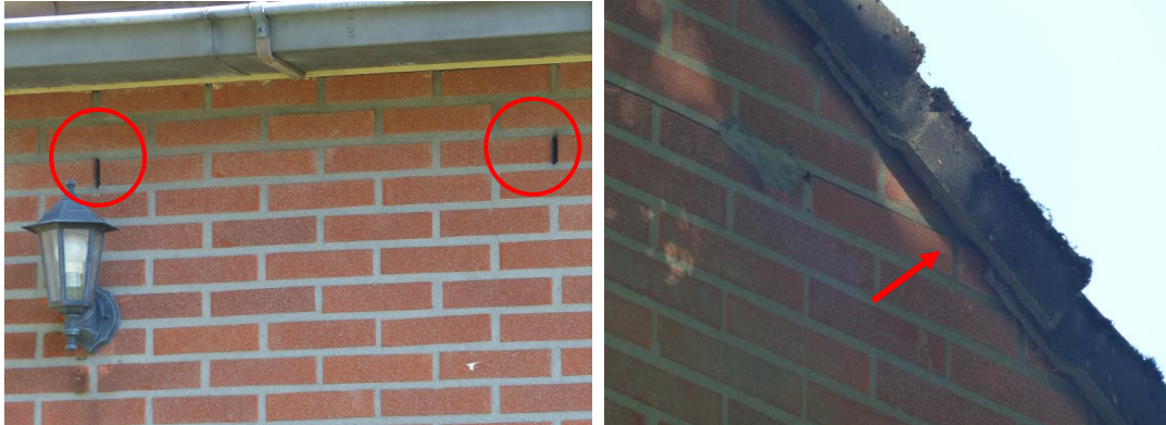
Foto 6 Open stootvoegen (links) en ruimte onder kantpannen (rechts) bieden invlieggelegenheden voor vleermuizen.
