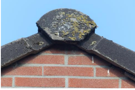
Foto 4 De nokpannen van de woningen aan het Van Echtenskanaal NZ zijn geschikt voor gierzwaluwen. Bij huisnummer 111 zijn uitwerpselen te zien. De nokpannen zijn ook geschikt voor vleermuizen.
