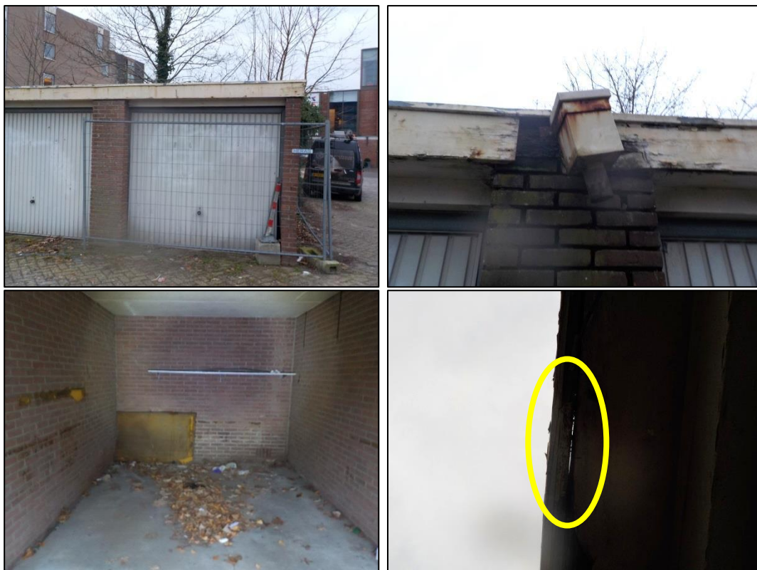
Figuur 5 Garageboxen ongeschikt voor vleermuizen vanwege enkelsteens muur, tochtige dakbetimmering.
